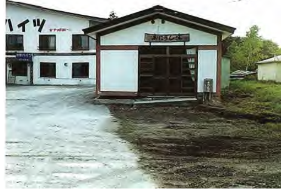
写真-1.11 液状化による住宅基礎の沈下 1-9)
