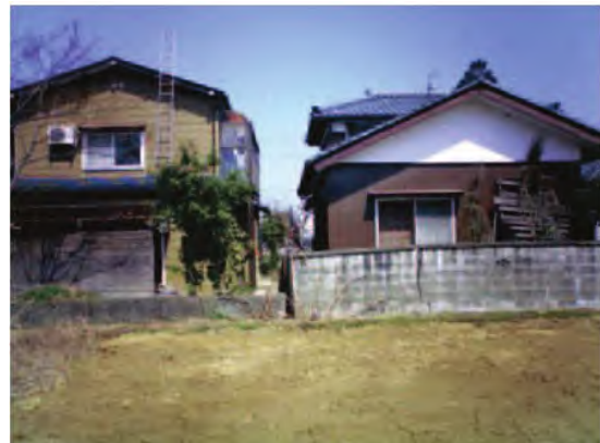
写真-1.19 住宅の傾斜被害 1-13)
