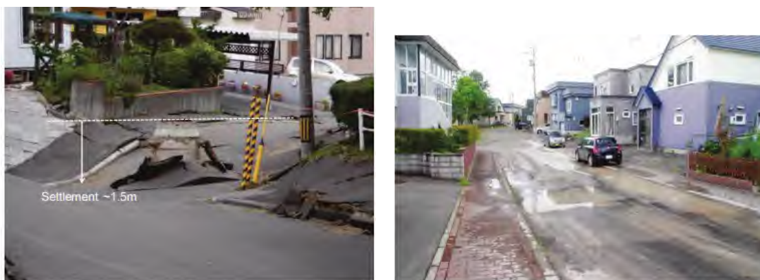
写真-1.33 地盤沈下により突出したマンホール 1-22) 写真-1.34 噴砂の状況 1-22)
