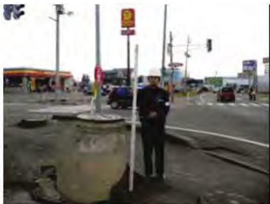
写真-1.20 マンホールの浮き上がり 1-13)
