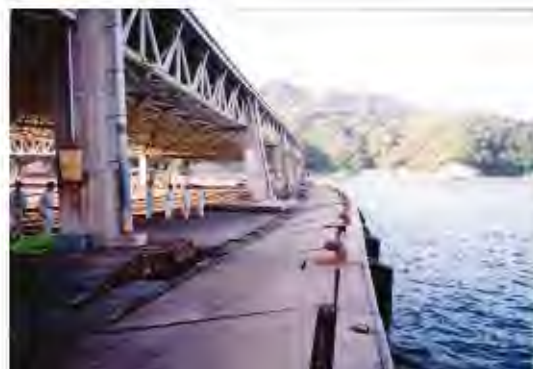
写真-1.16 前面にはらんだ岸壁 1-12)
