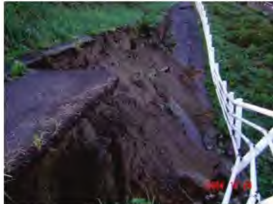
写真-1.21 国道8号ののり面崩壊 1-13)
