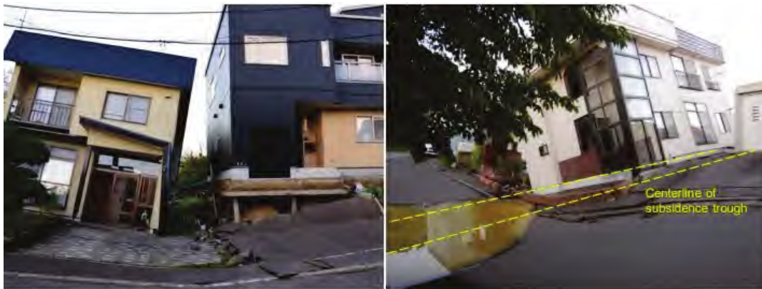
写真-1.32 傾斜した住宅 1-22)
