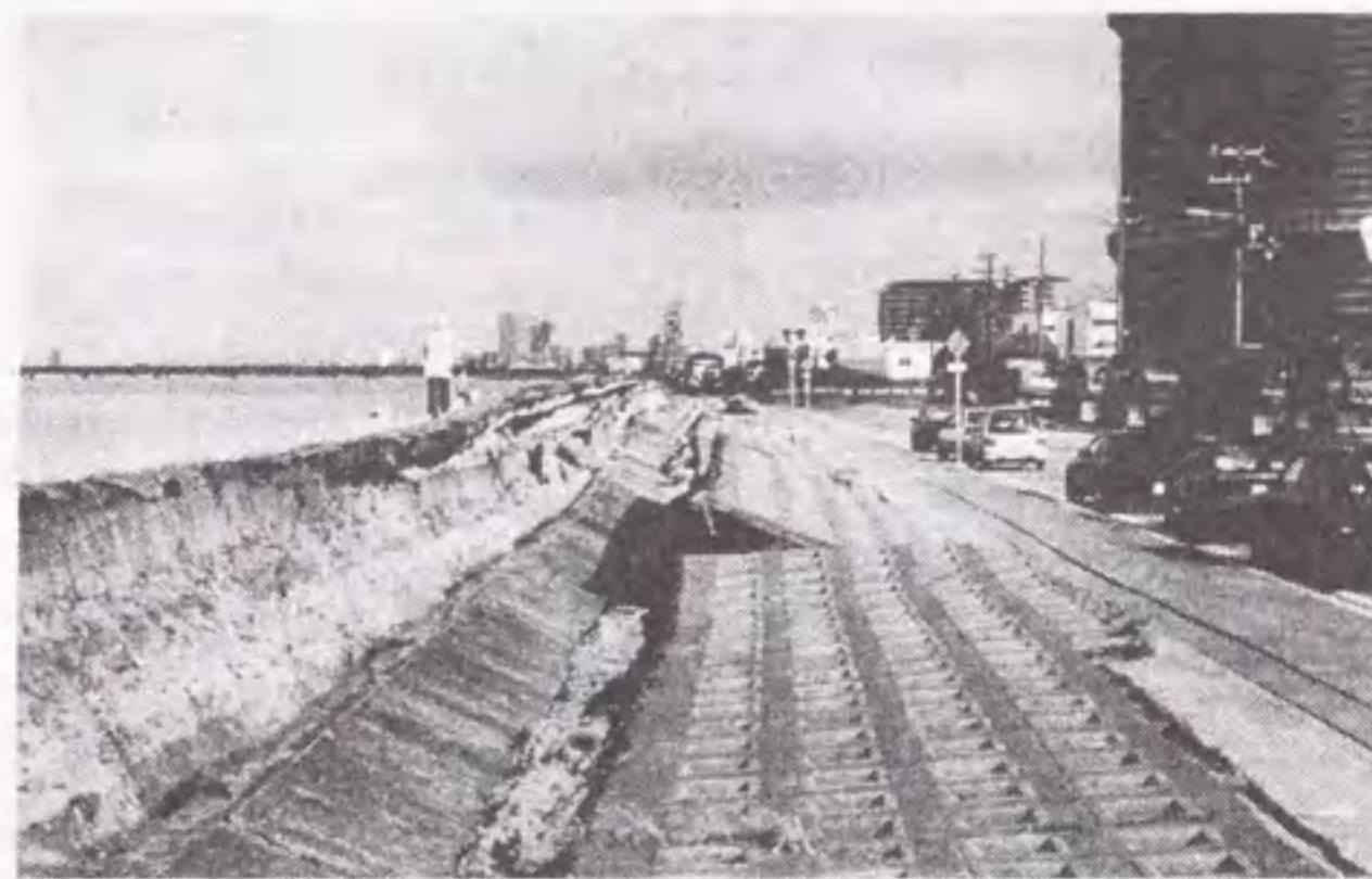
写真 5.2 被災堤防付近の様子 (日本建築学会・土木学会, 1995)
