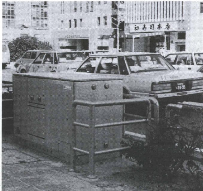
(b) 変圧器塔
