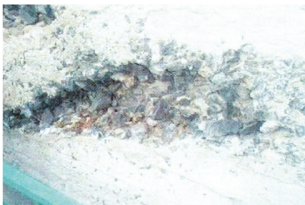
写真-1.4 既設堤体の劣化状況
