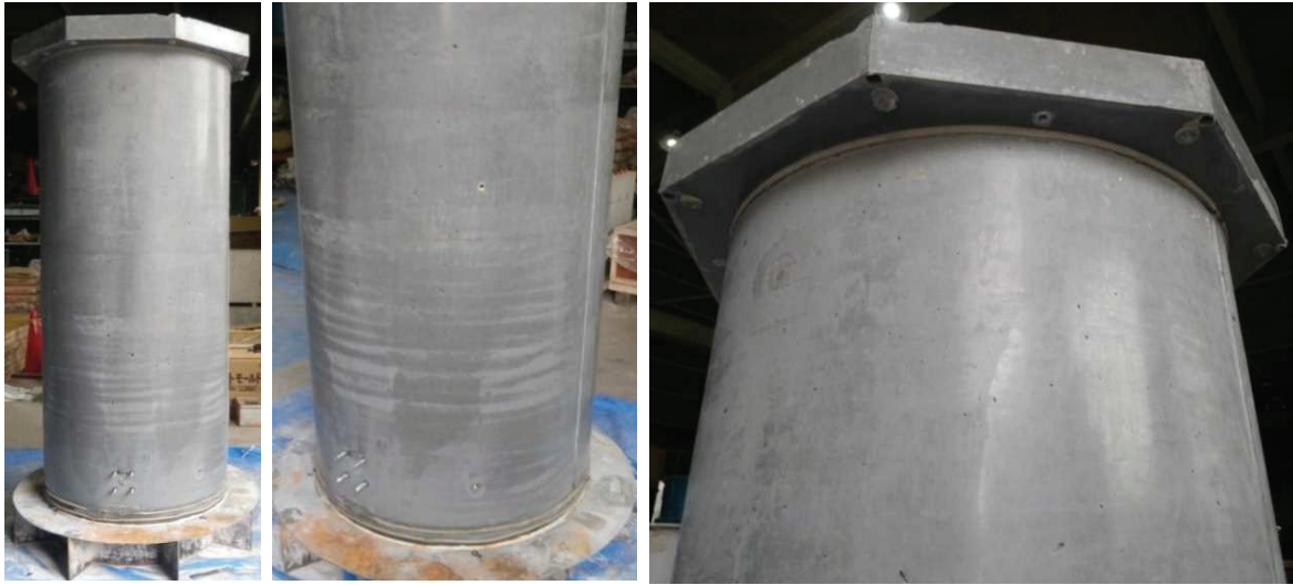
写真-8.7 型枠脱型後の巻立て表面
