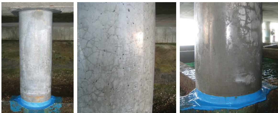
写真-4.1 実栈橋鋼管杭にUHP-SHCCを巻き立てた後に観察された表面ひび割れ発生状況
