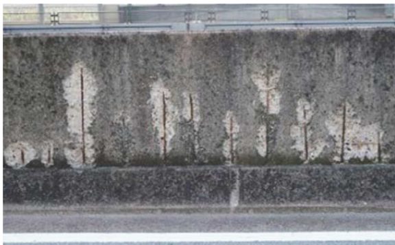
補修前の壁高欄の劣化状況
