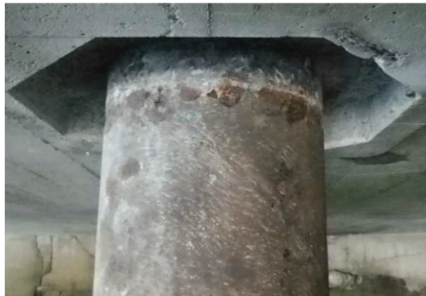
写真-1.2 鋼管杭と上部工の接合部において腐食が進行している事例
