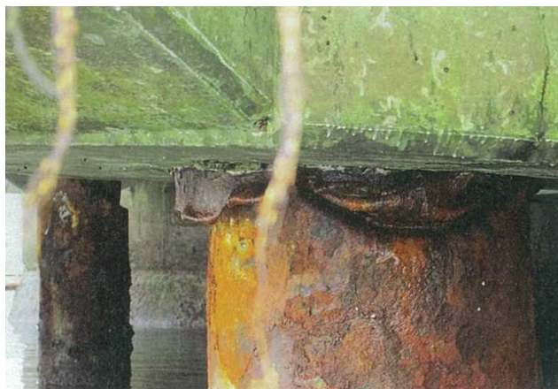
写真-1.3 鋼管杭の圧縮変形により上部工が沈下した事例 [5]
