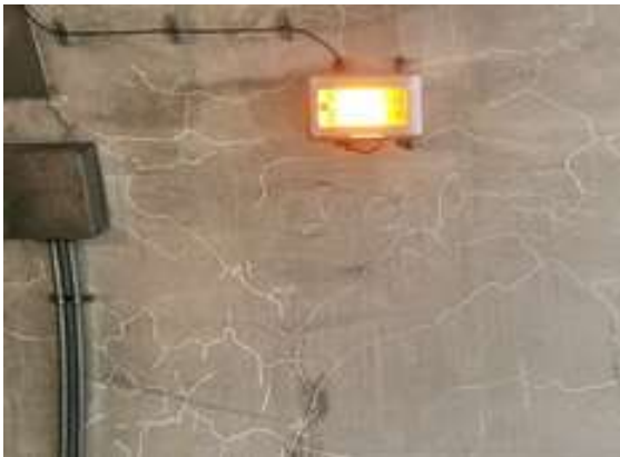
トンネル照明設備周辺【1.12】
