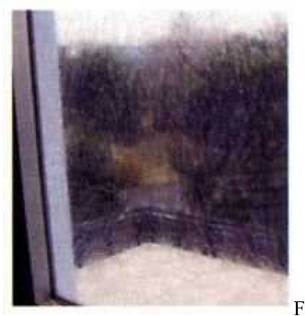
Fig.1-12 P E T フィルムの劣化
