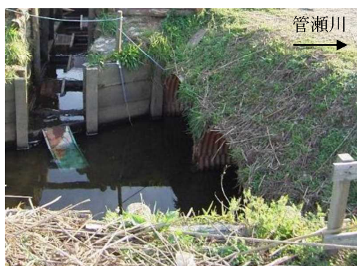
Fig.2-8 排水路と管瀬川の合流部
