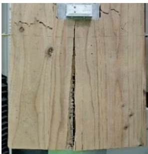
(b).外層ラミナの割裂破壊 (CLT-P)
