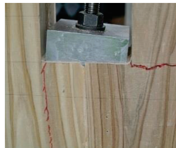
(f).座金のめり込み破壊 (CLT-I)
