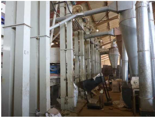
写真 4.6 MRGM の精米機
