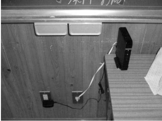
写真2 教室へのWi-Fiルータの設置
