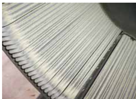
図 14 ヒーターチューブにおける灰付着状況写真
